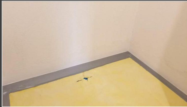
Zabezpieczenie podłogi na czas wykonania ścian, z otworem na odprowadzane wilgoci z odpływu.
